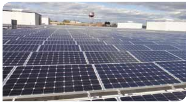
> 2MW, Chicago, IL, USA
