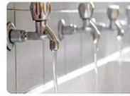
İçme suyu sistemleri
